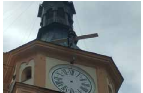
Die Uhrzeiger mussten abmontiert und ein Gerüst rund um das Gesims gebaut werden.
